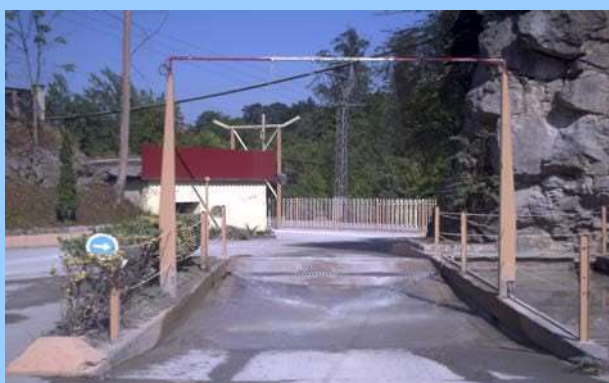
Fotografía 5.5. Foso para Lavado de Ruedas de Camiones
