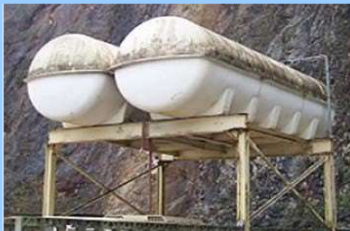
Fotografía 4.3. Depósitos para Recogida de Aguas
